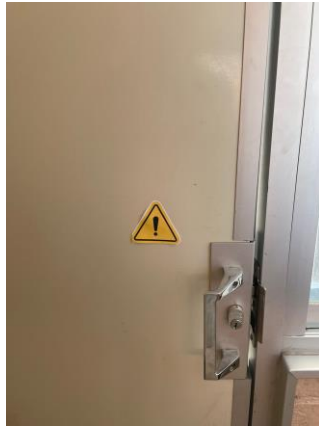
Fotografía 6. Símbolo de peligro en la puerta del salón.
