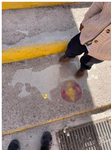
Fotografía 12. Símbolo de peligro en escalón.
