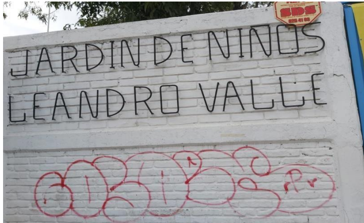
Anexo A. Fachada del jardín de niños Leandro Valle bandalizada.
